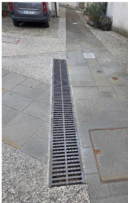
Urejena odvodnja meteorne kanalizacije z manipulativnih površin
