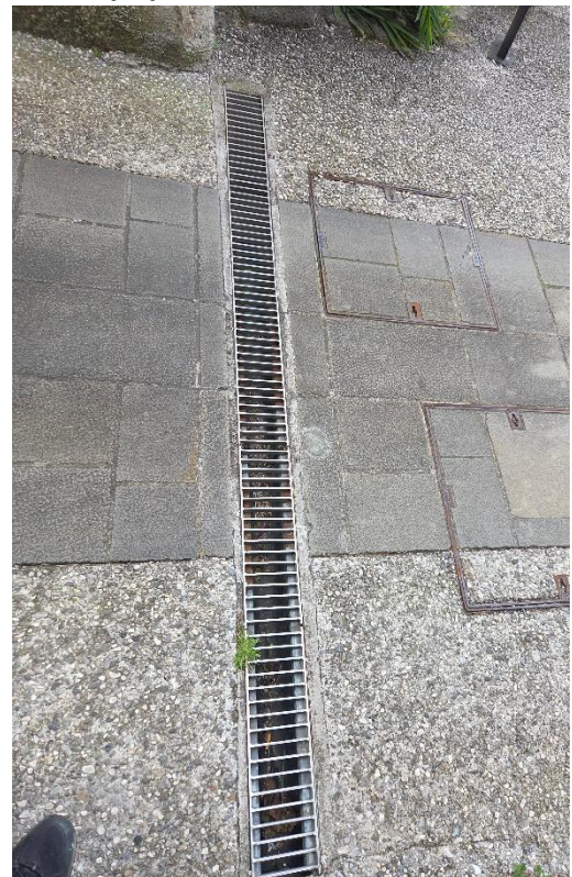
Urejena odvodnja meteorne kanalizacije z manipulativnih površin
