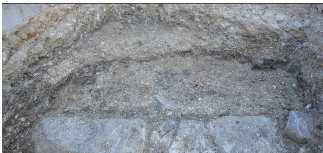
Slika 123: Detajl poškodovanega maltnega tlaka (foto: U. Košir, 2017).
