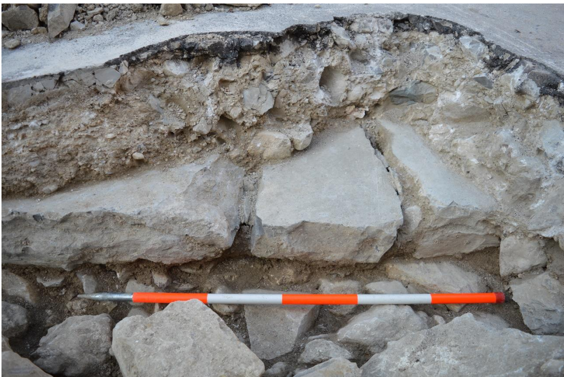
Slika 158: Kamniti kanal, s katerim je bilo poškodovano obzidje (foto: U. Košir, 2017).
