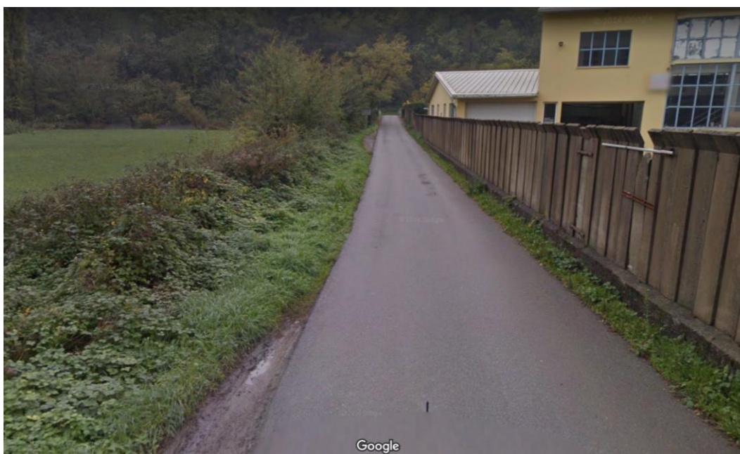
Slika 10: Ograja/Zid iz prefabriciranih elementov v sedanji obliki ne more zadržati visoke vode (Google Maps https://www.google.si/maps/ )
