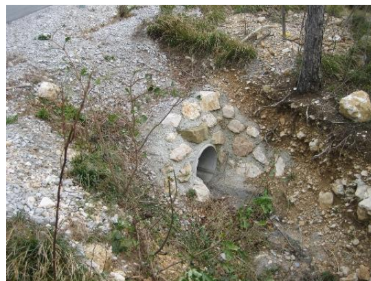
Slika 3 Iztok iz cevnega prepusta DN600
