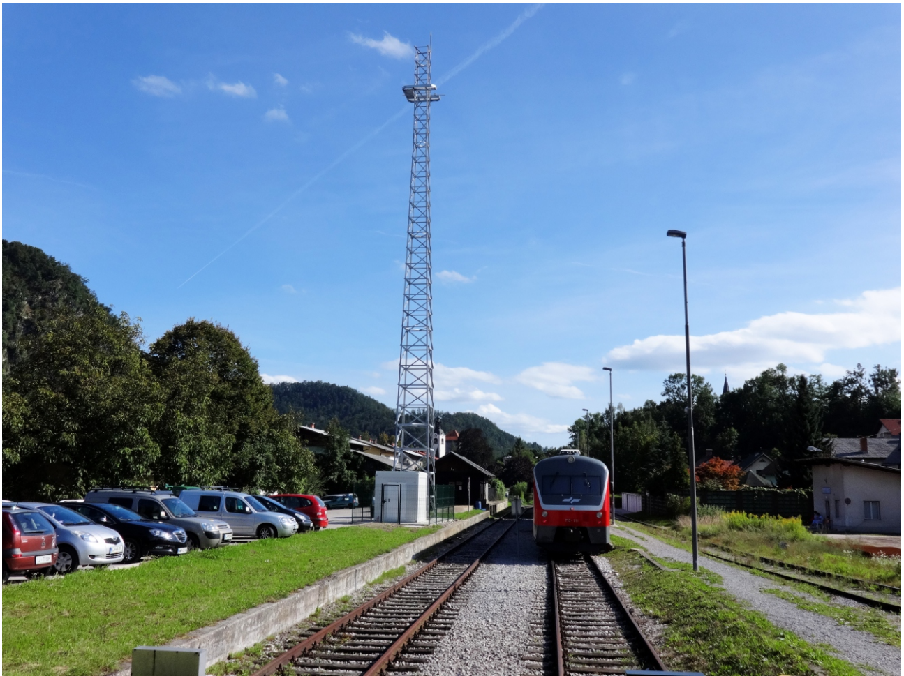
Slika 3: primer bazne postaje GSM-R
