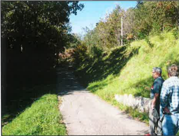
Potek vodovodne veje V4 čez plazovit del pobočja (plaz nad cesto, posecki zunanjeja roba ceste).
