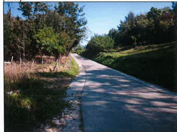
Vodovodna veja V5 ob plazovitem delu pobočja (na desni), neurejeno odvodnjaavanje, močila na cesti.
