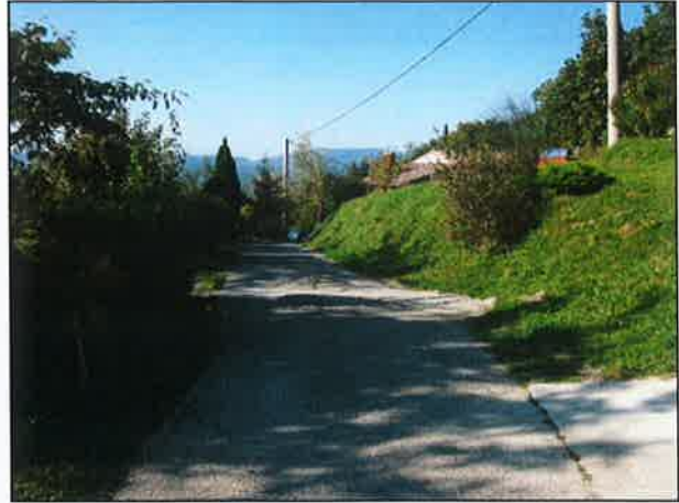
Potek vodovodne veje V4 čez plazovit del pobočja (pnagubano in posedeno cestišče), pri zaselku Ljubljanica.
