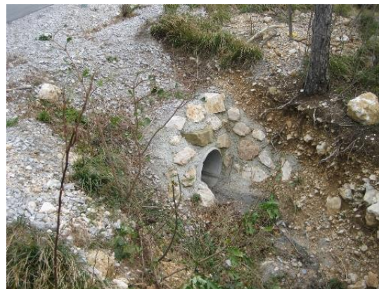
Slika 3 Iztok iz cevnega prepusta DN600
