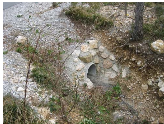
Slika 3 Iztok iz cevnega prepusta DN600
