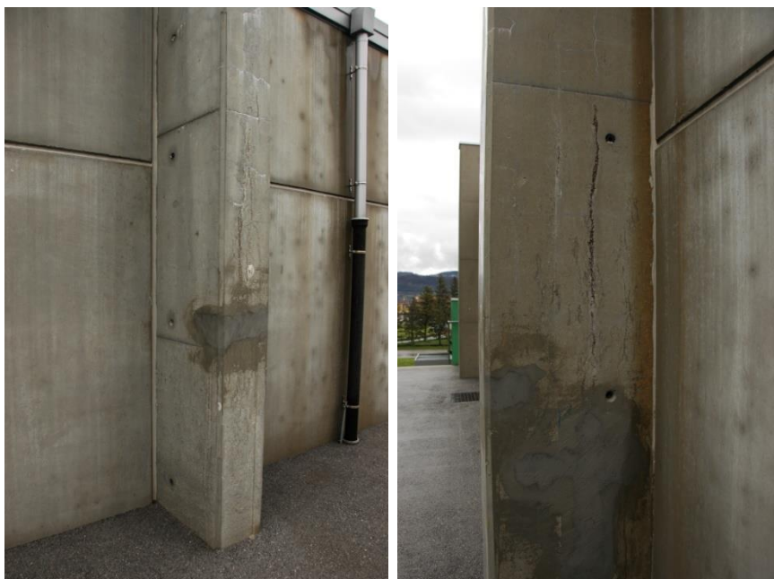
Slika 4: poškodbe stebra v osi 2
