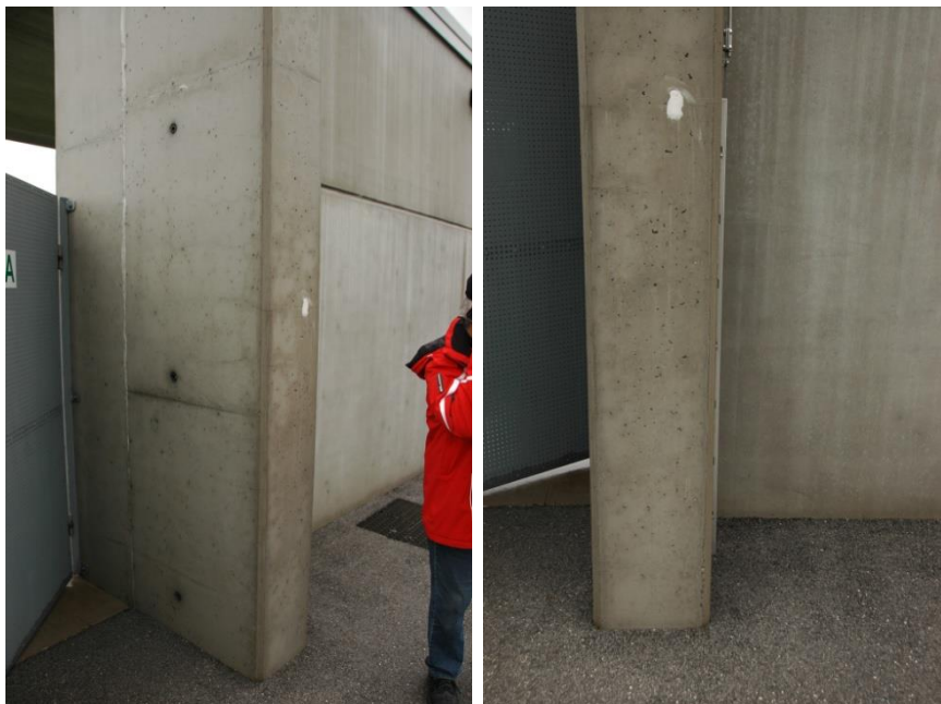
Slika 3: poškodbe stebra v osi 1
