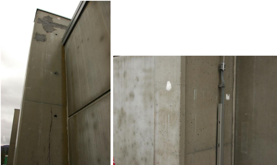
Slika 5: mesto sondažnega izseka in tipična natezna razpoka na višini ca 1,50 m
